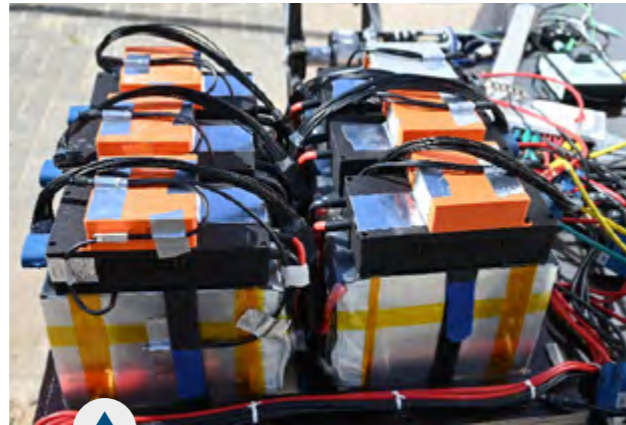
De batterijen met daarop instrumentatie voor het monitoren van elektrische parameters.
